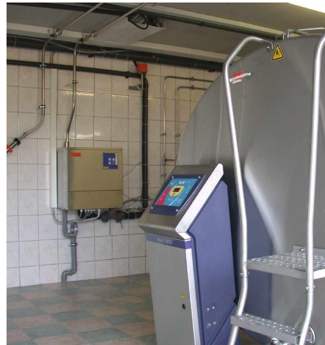
Mit dem 5.000-Liter Tank ist der Betrieb für die Zweitagesabholung ab Januar gerüstet.
